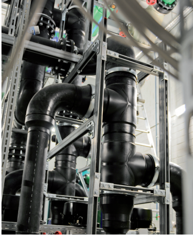
FIGURA 6. Las tuberías electroconductoras son obligatorias en áreas explosivas.
