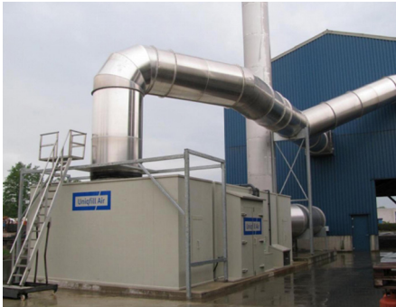
FILTROS DE AIRE
