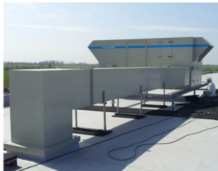
CONDUCTO DE VENTILACIÓN
