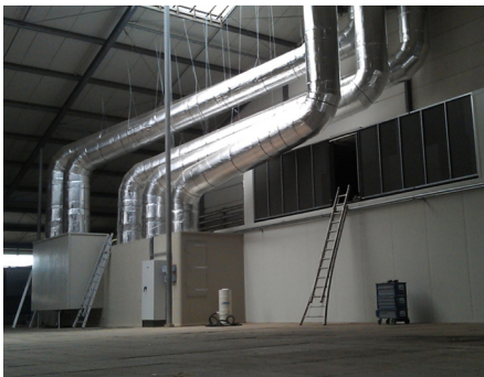
DEPURADOR DE AIRE INDUSTRIAL
