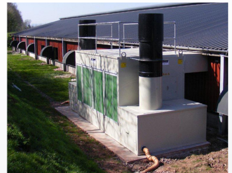
DEPURADOR DE AIRE
