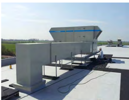
CONDUCTO DE AIRE
