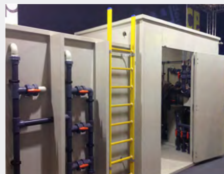
SALA DE CONTROL
